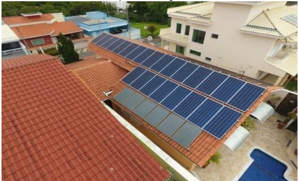
FIGURA 17 – modelo sobre estrutura de telhas de barro com associação de placas de aquecimento de agua.
