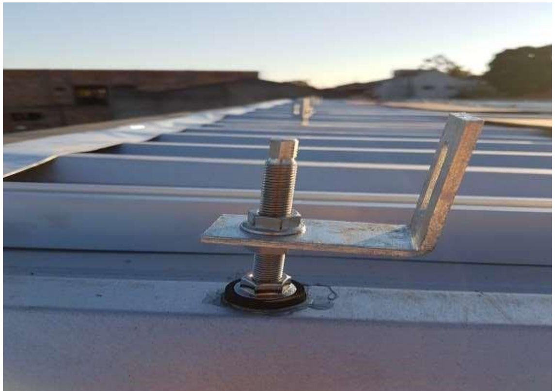
FIGURA 19– Pino com isolante comra vazamentos em estrutura metalicas.
