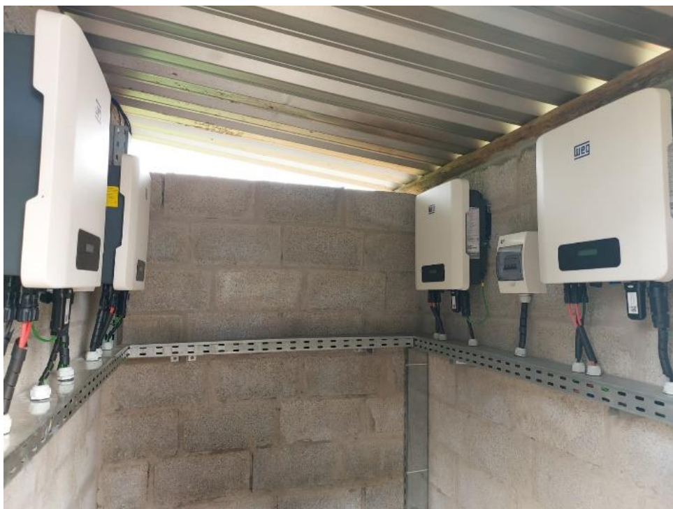
Figura 16 –Inversores WEG 6 KW
